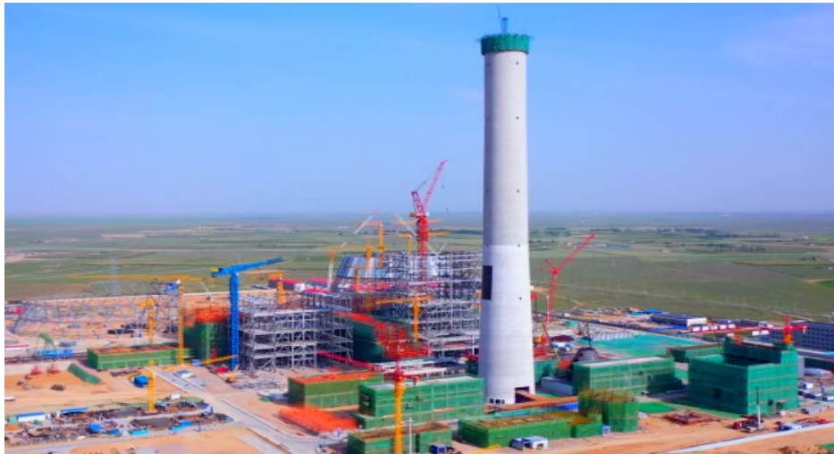
图 9-3 某火电厂 5G 专网项目
