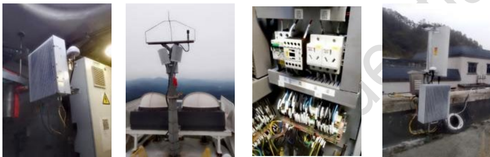
图 9-7 智慧风电现场部署
